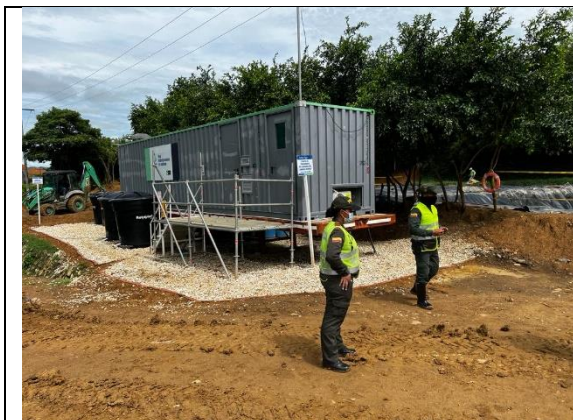
Foto 1. Vista planta de osmosis inversa.
