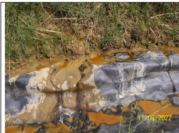
Foto 5. Afloramiento de lixiviados en base de talud
