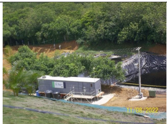
Foto 2. Vista planta de osmosis inversa.
