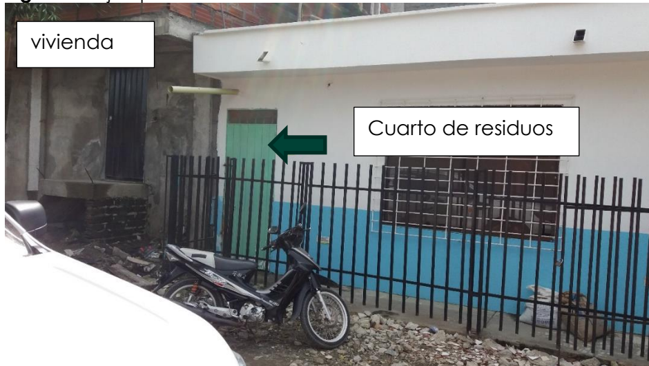
Figura 14. Ejemplo de cuarto de almacenamiento de residuos mal ubicado.
