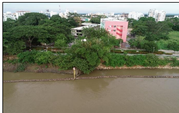
Figura 22. Obra de infraestructura realizada por la CVS en la ronda Norte del municipio de Montería, como medida de adaptación.
