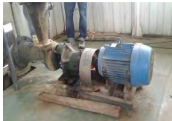
Equipo de captación instalado en barcaza flotante
