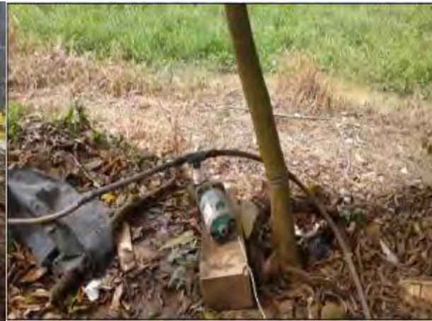
Bomba centrifuga de eje horizontal de succión negativa instalada sobre la corriente principal del Caño Bugre
