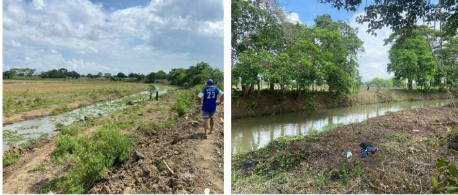
Ilustración 14. Limpieza de caño y rocería vs Limpieza de caño y rocería. Fuente: CVS, 2023
