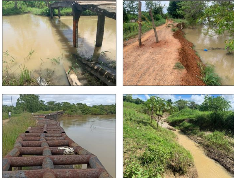
Ilustración 123. Registro fotográfico de las actividades de seguimiento y monitoreo de los niveles de los ríos Sinú, San Jorge y Canalete, la Quebrada Uré, Caño Grande y Caño Sicará. Fuente: Equipo técnico SGA, 2022.
