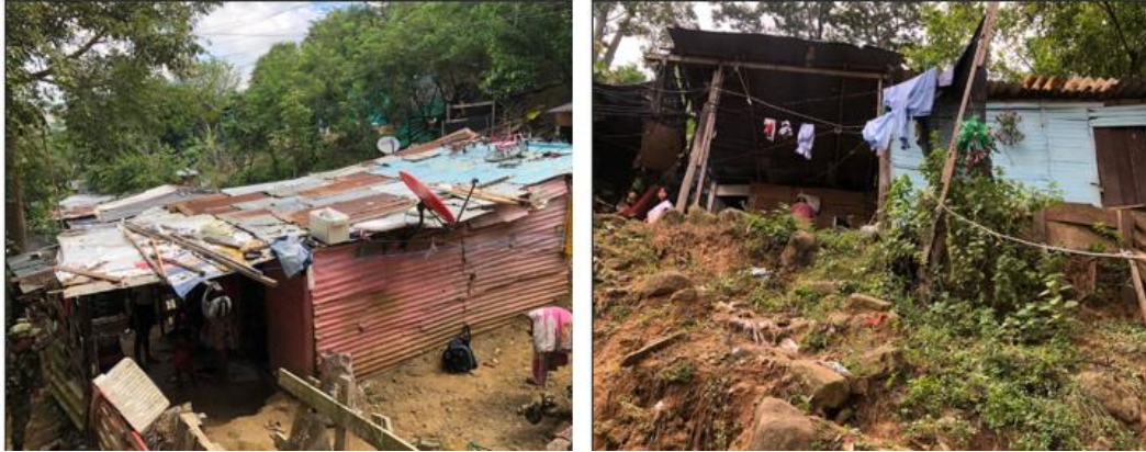
Ilustración 157. Registro fotográfico – condiciones de vulnerabilidad física de las edificaciones en el área de estudio. Fuente: Equipo técnico SGA, 2022
