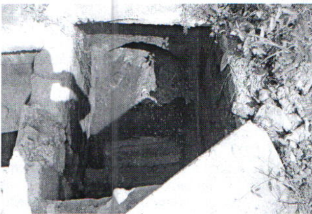
Foto N° 3. Se puede observar punto de vertimiento de aguas.
