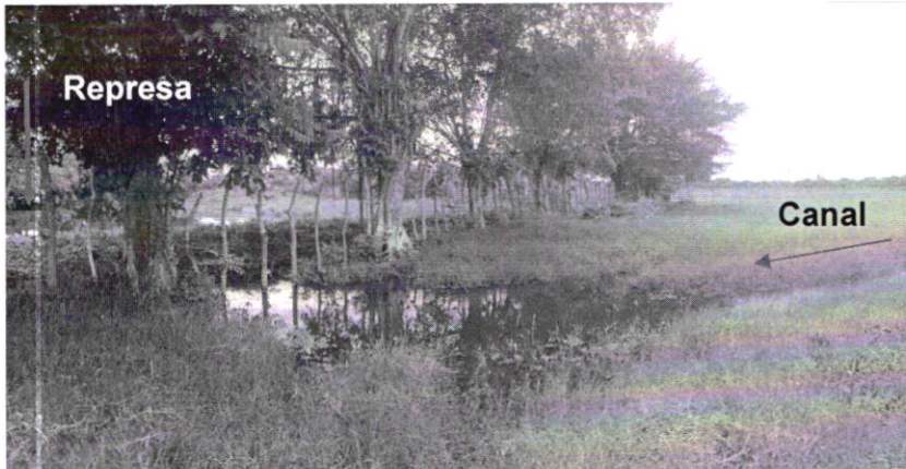
Foto N° 2. Se observa encharcamiento debido a que el canal construido al lado de la represa para transportar el agua del caño, y que recibe el canal mostrado, no tiene suficiente capacidad hidraulica.
