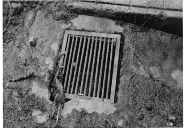
Foto N° 4. Registro para luego enviar al alcantarillado..
