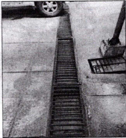
Foto No.2. Canales de recolección de aguas grises
