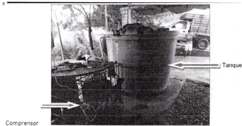
Foto No 5. Tanque de almacenamiento de agua y compresor.
