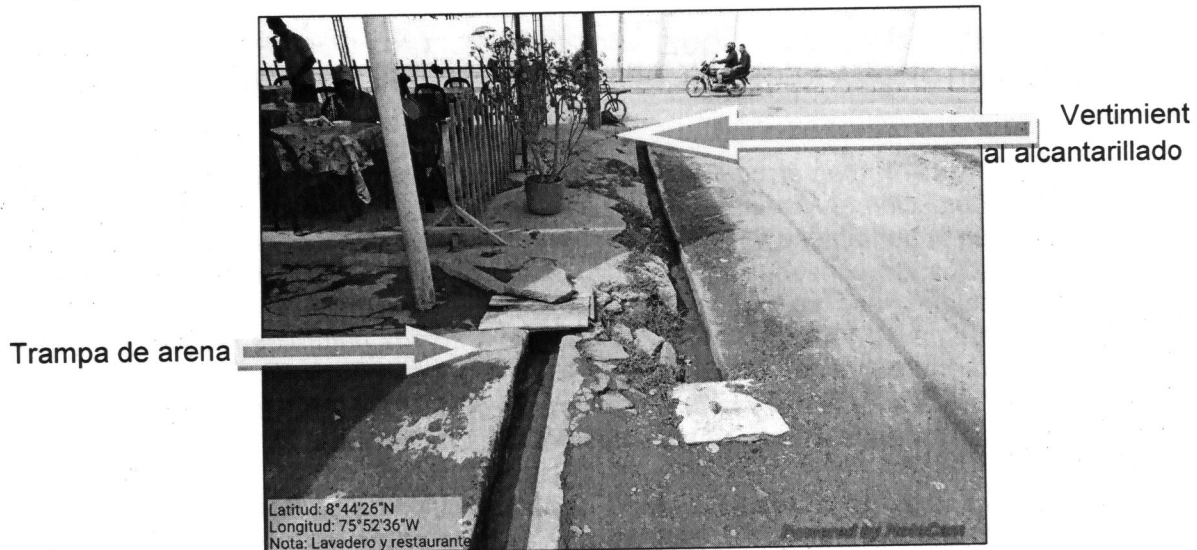
Foto No.3. Punto de vertimiento aguas grises al alcantarillado.
