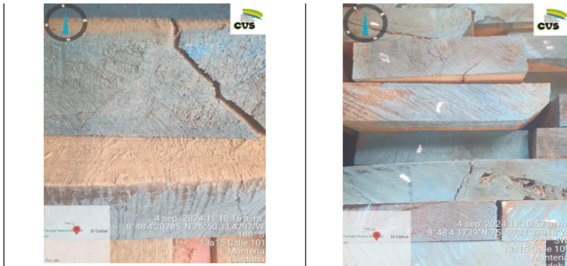
Imagen 5 Evidencia de grietas y fisuras
