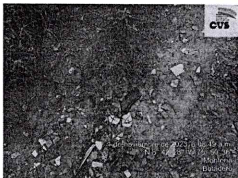
Foto 13. Presencia de RCD en el sitio.
