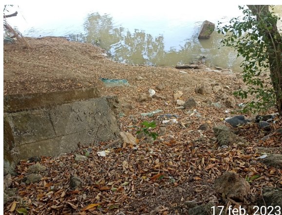
Foto 39. Disposición inadecuada de residuos sólidos
