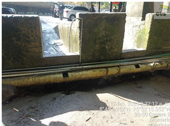
Foto 20. Tubería de conducción de aguas residuales
