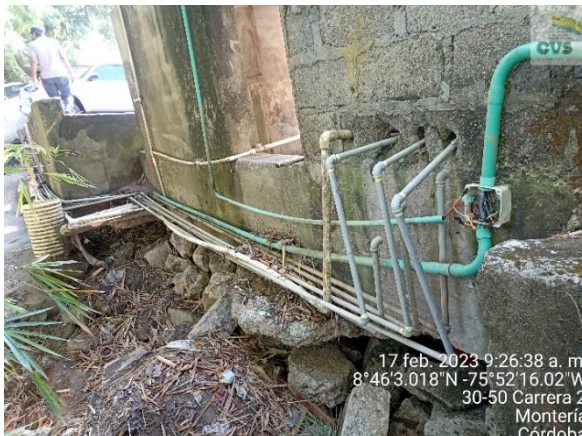
Foto 22. Tuberías de conducción de aguas
