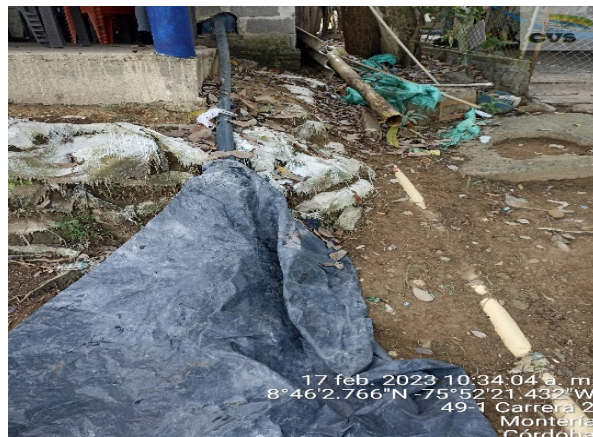
Foto 54. Tubería usada para captación de agua
