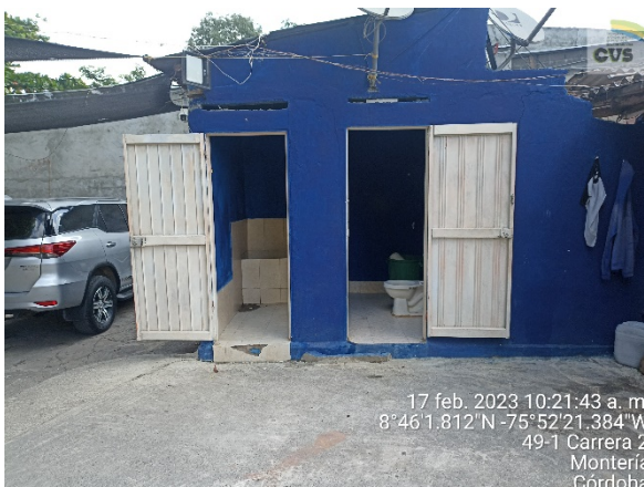
Foto 50. Baños en funcionamiento en el establecimiento
