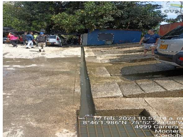
Foto 62. Sistema de drenaje de agua en la zona de lavado de vehículos
