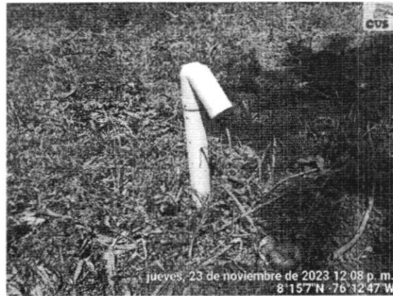
Foto 10. Chimenea de desfogue presente en el sitio.
