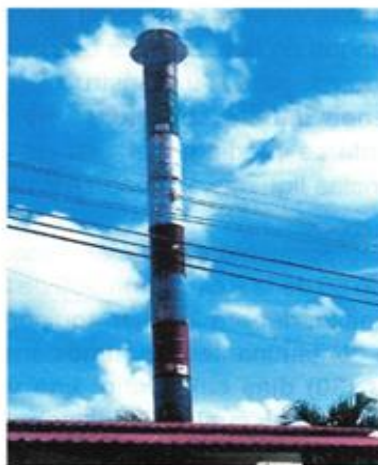
Imagen 2. Ducto de descarga de emisiones atmosféricas
