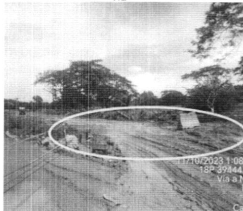
Imagen 1. Residuos vegetales alrededor de la vía
