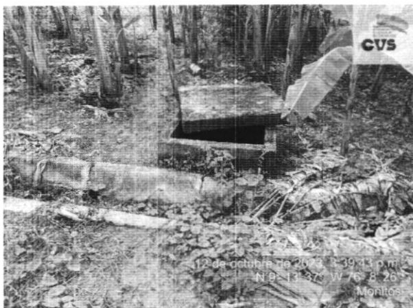
Foto 3. Canales perimetrales obstruidos y/o sedimentados, y Tanque almacenamiento de lixiviados.
