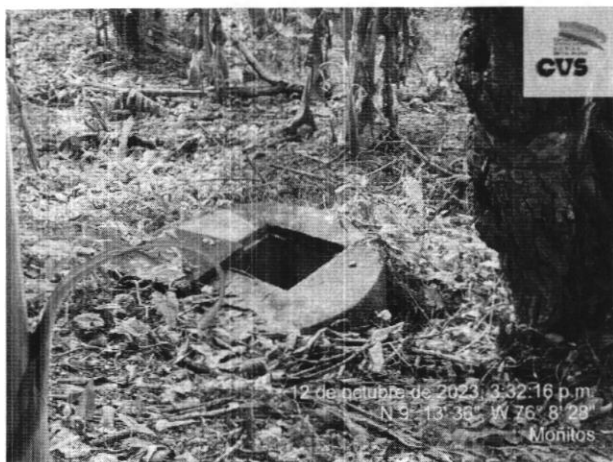
Foto 5. Caja de registro de lixiviados en regular estado
