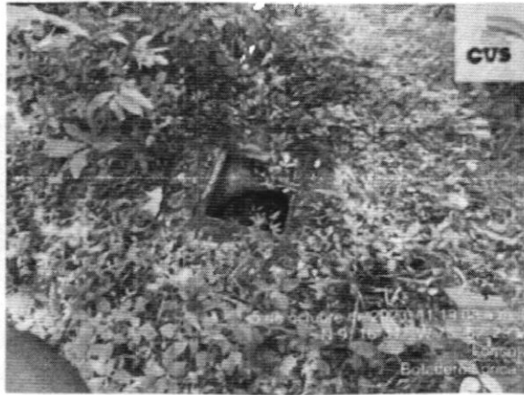
Foto 2. Caja de registro en el predio.
