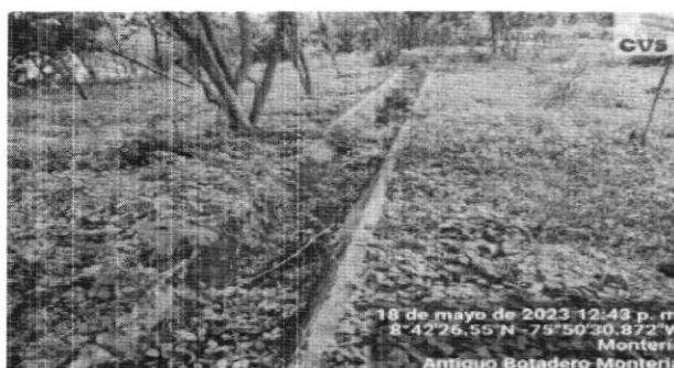
Foto 3. Estado de canales pluviales en el sitio
