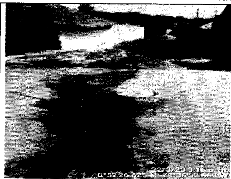
Foto 3. Las aguas residuales siguen su recorrido hacia las calles sin pavimento del barrio San Isidro
