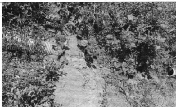
Tubo entrada roto
