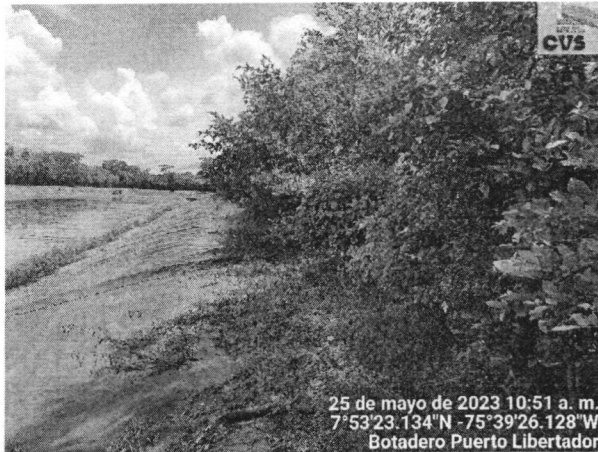
Foto 7. Estado del cercado perimetral.
