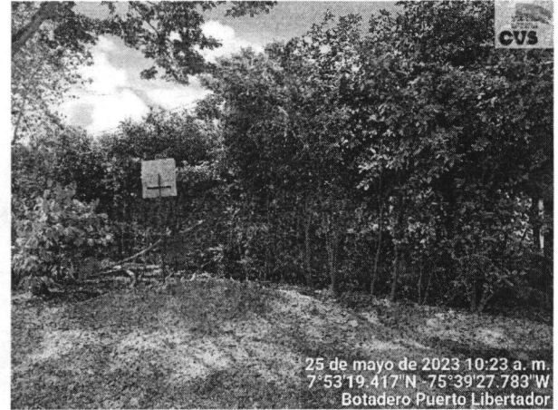
Foto 8. Estado del cercado perimetral.
