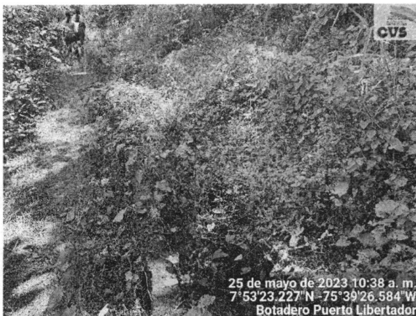
Foto 9. Estado de canales de aguas lluvias
