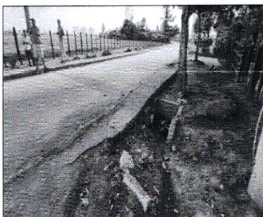
Foto 3. Inadecuada disposición de residuos sólidos que genera obstrucción o taponamiento del drenaje.
