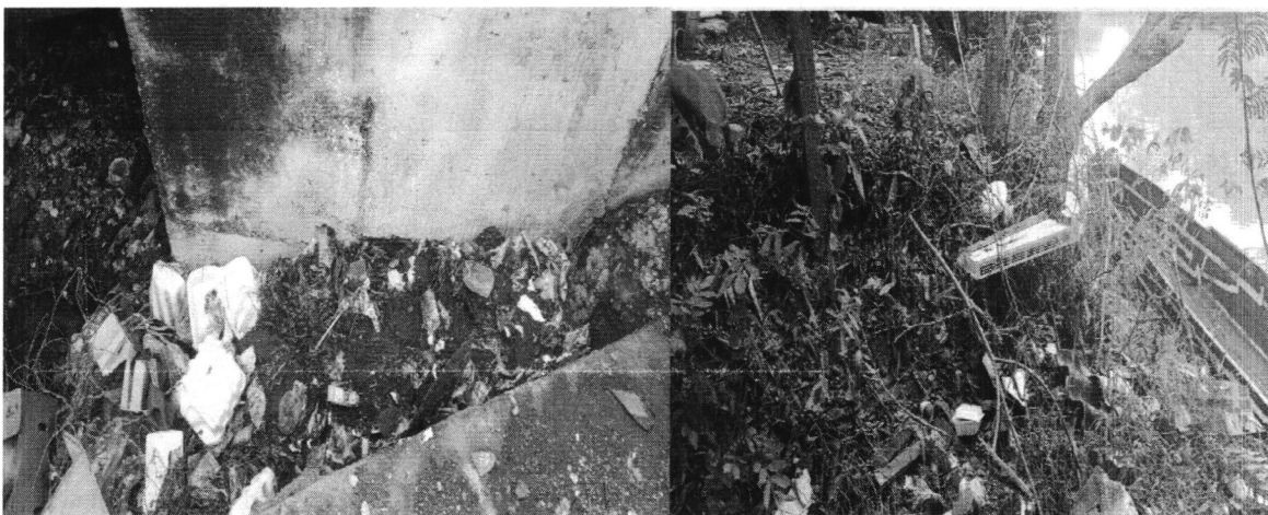
Imagen 7 y 8. Disposición inadecuada de residuos sólidos debajo de la estructura del Puente, en la margen derecha del Caño Aguas Prietas, en el municipio de Santa Cruz de Lorica.
