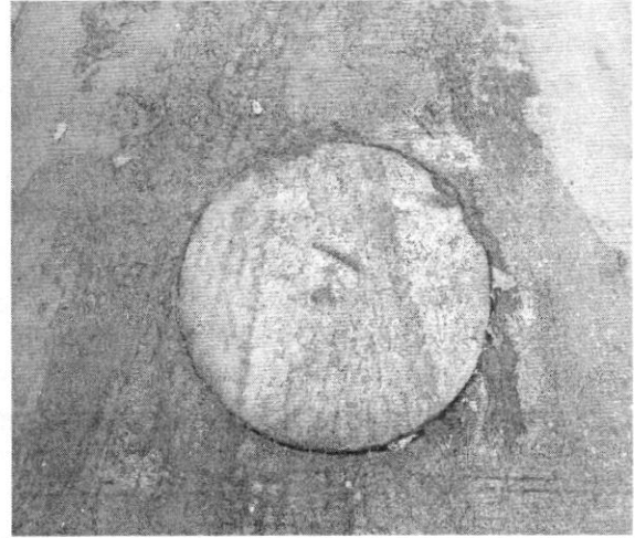
MANHOL REBOSADO CRA 8
