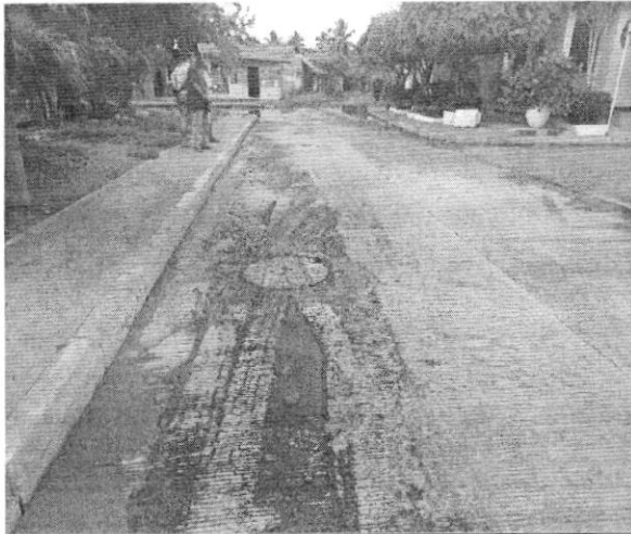
MANHOL REBOSADO CRA 8
