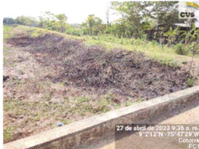
Foto 7. Presencia de incineración en el canal de drenaje #8.
