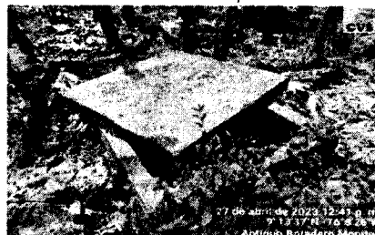
Foto 4. Tanque almacenamiento de lixiviados.
