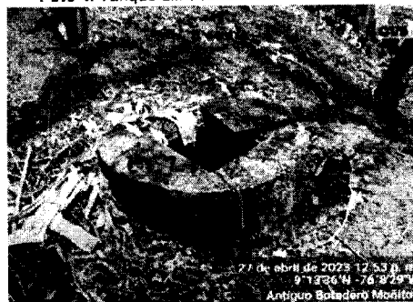
Foto 6. Caja de registro de lixiviados en regular estado.
