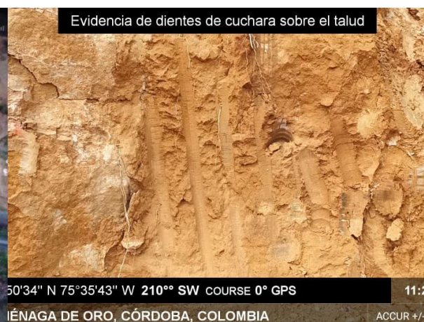
Foto 4. Vestigios de los dientes de la cuchara de maquinaria.
