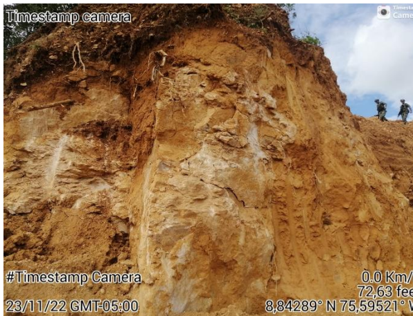
Foto 5. Vestigios de los dientes de la cuchara de maquinaria.
