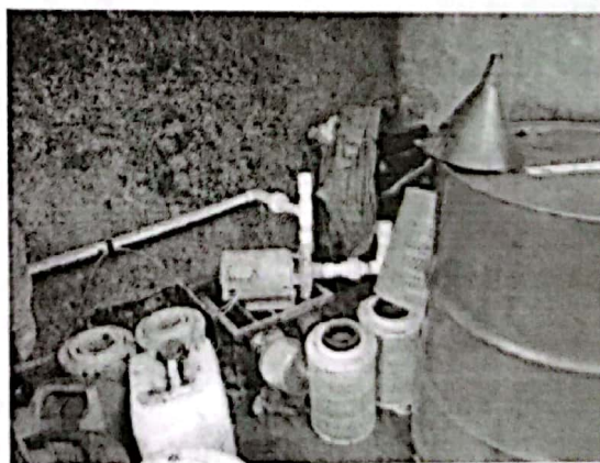
Fotografía. Sistema de captación del aljibe 2
