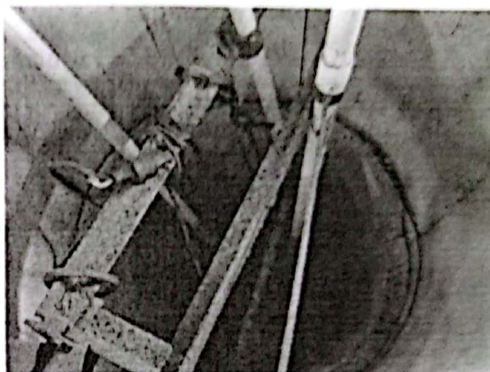
Foto 2. Captación Aljibe EDS Las Palmas
