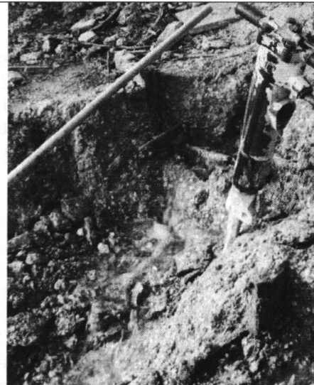
Foto 6. Salida de agua por punto de anterior cerramiento
