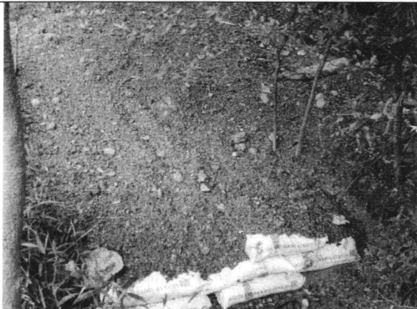
Foto 9. Vista de taponamiento evidenciado el 5 de julio de 2022
