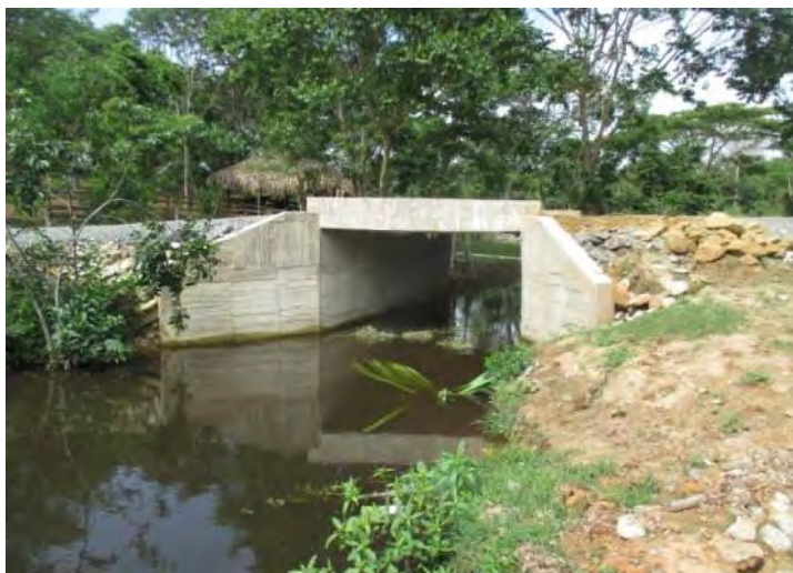
Ocupación de cauce sobre cuerpo de agua – Vías terciarias Municipio de Los Córdoba
