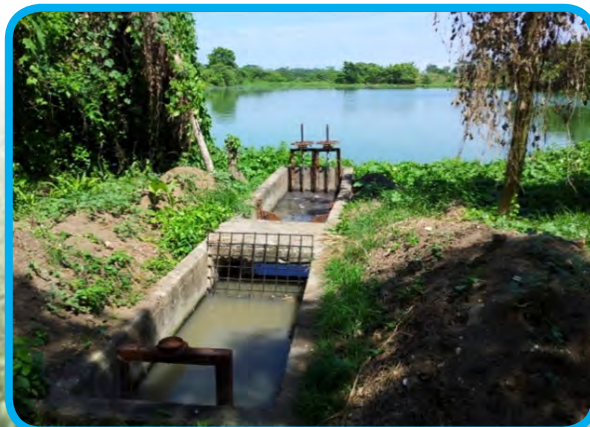
Foto 2.31 Lagunas de estabilización AGUAS DEL SINU S.A municipio de San Antero
