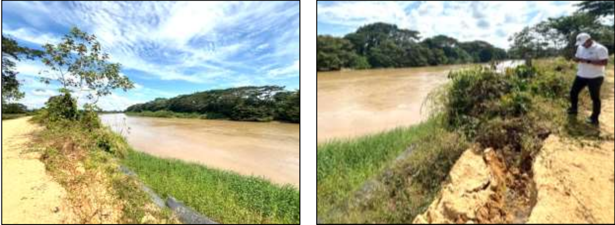
Figura 8. Visita de seguimiento a puntos críticos en el río San Jorge, municipio de Pueblo Nuevo, departamento de Córdoba - Informe de visita GGR No. IV 2025 – 868.
