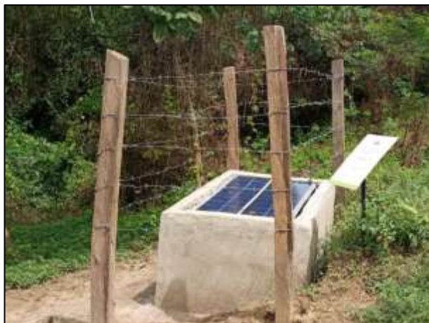
Figura. Sensor de movimiento de tierras – acelerómetro, instalado en el cerro Colosiná, municipio de San Carlos.
